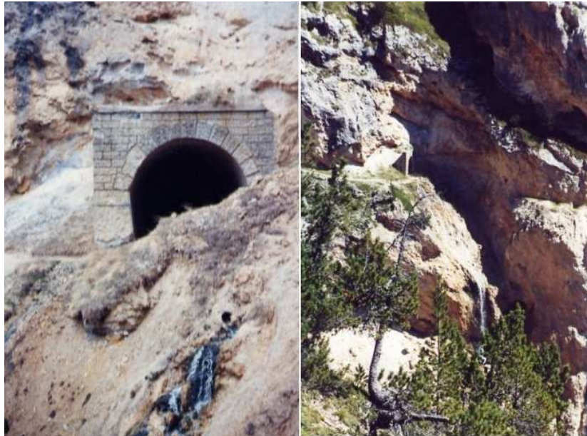
vecchio ingresso e strada franata
